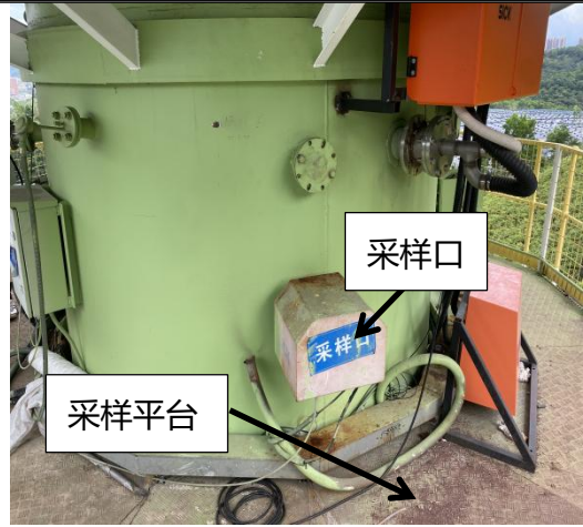
焚烧烟气采样平台、采样口
