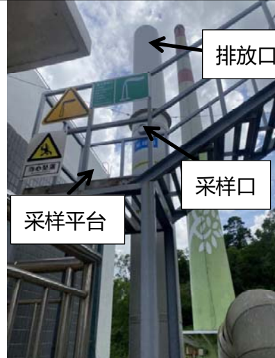
分析室废气采样平台及采样口、排放口
