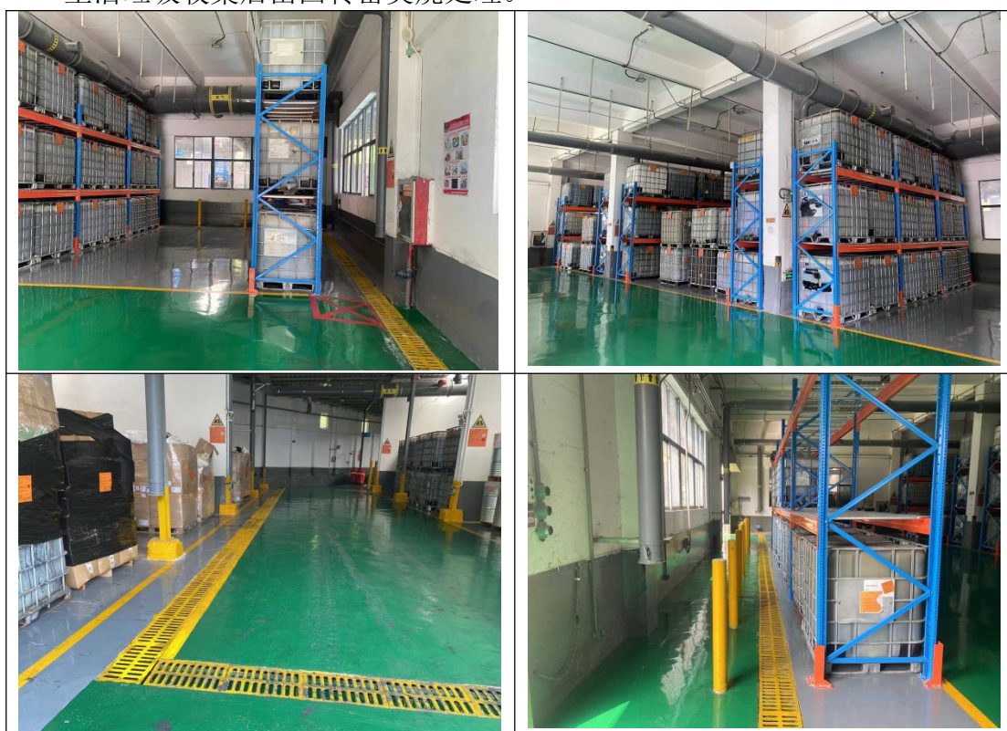
图 3.1-6 危废暂存仓库防渗漏、防雨淋、防腐蚀、截流沟等措施
