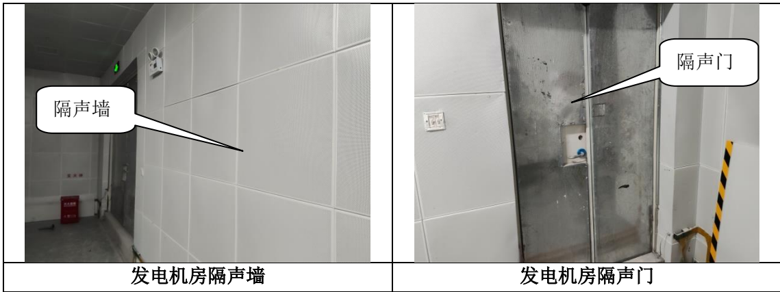
图 6.3-8 备电机房隔声减振措施
