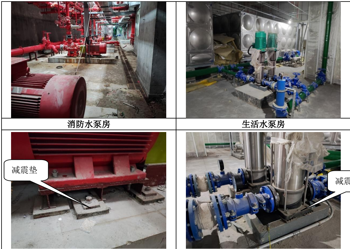
图 6.3-9 消防泵房、生活水泵房减振隔声措施
