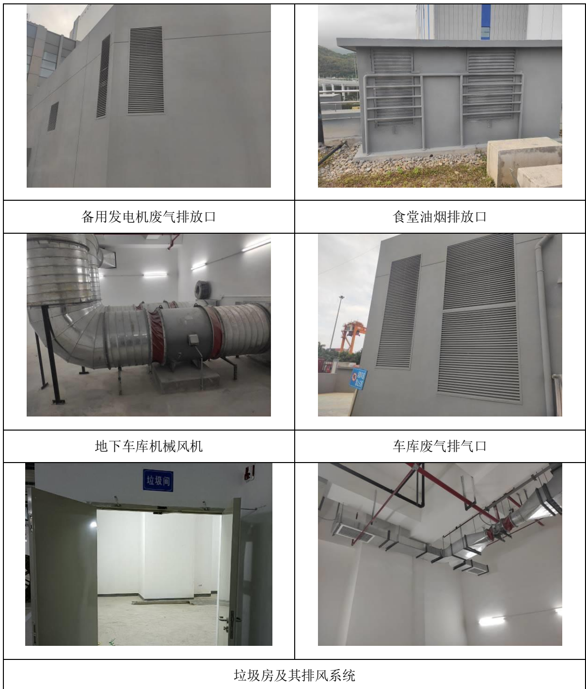
图 4.1-3 废气处理设施及排放口
