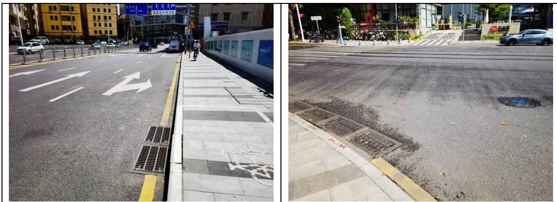
图 8-3 路面径流收集系统照片
