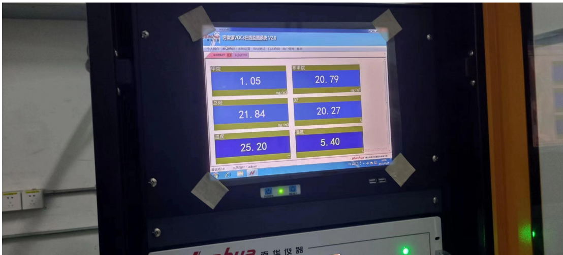
图 2-14 废气在线监控设施现场调试运行图
