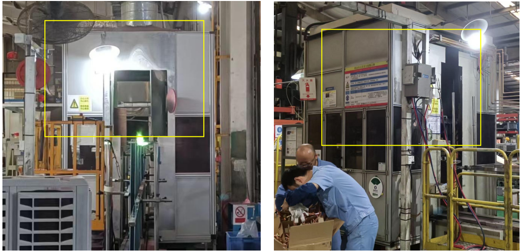
图 4-2 热交工序现场废气收集情况图（负压焊接车间收集）
