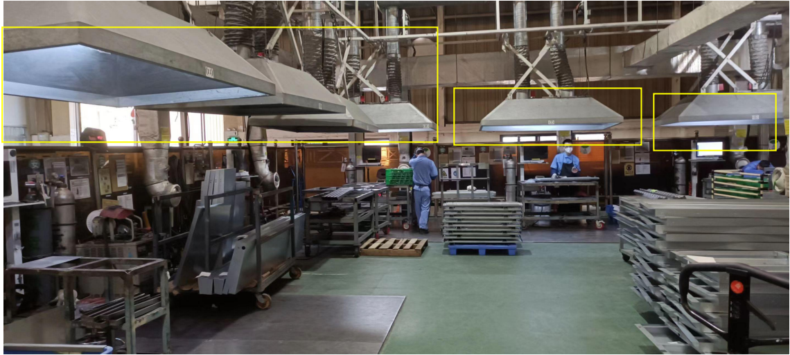
图 4-9 钎焊工序现场废气收集情况图（集气罩收集）
