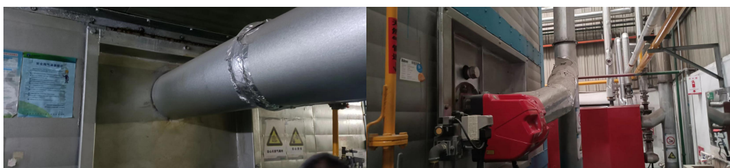
图 4-8 粉烘房、水烘房燃烧工序现场废气收集情况图（废气直接和排气筒相连，不与外界空
