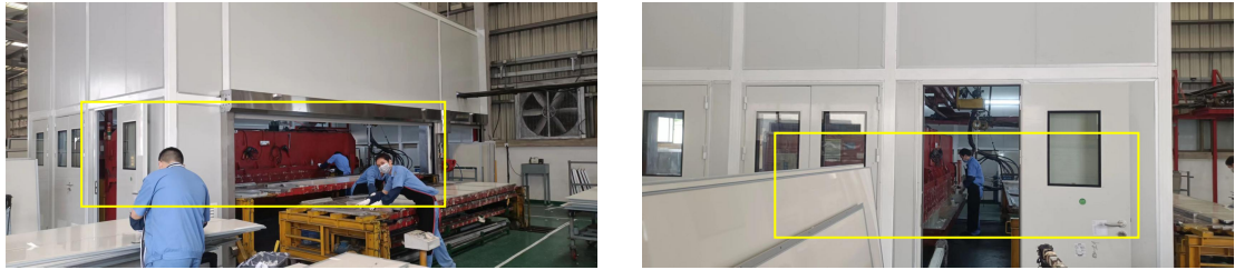
图 4-4 泡工序现场废气收集情况图（密闭负压收集）
