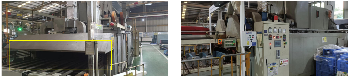
图 4-3 高温脱脂工序现场废气收集情况图（集气罩收集）
