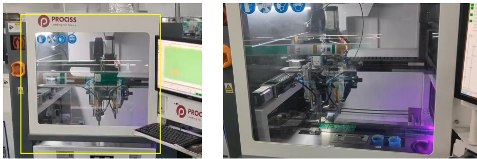
图 4-13 三防漆喷涂覆盖工序现场废气收集情况图(整体密闭负压收集)
