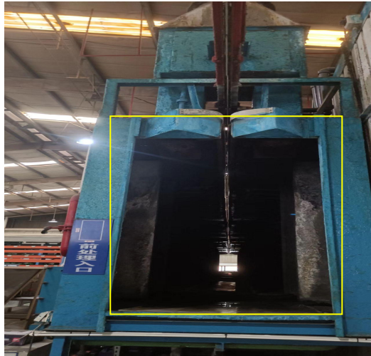
图 4-6 除油脱脂工序现场废气收集情况图（收集罩收集）
