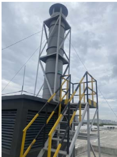
废气排放口及采样平台
