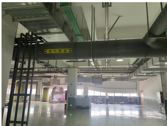
车间废气收集系统
