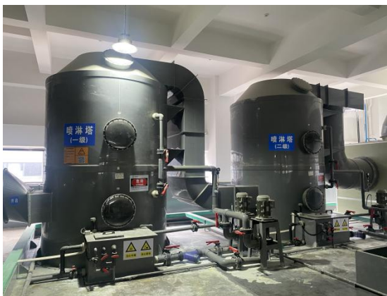
废气组合净化系统（整体）
